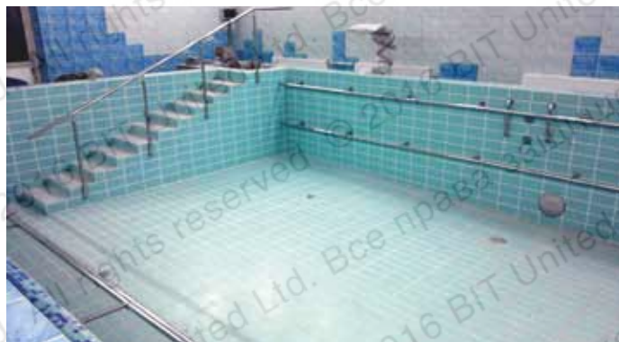
Монтаж поручней из нержавеющей стали в плавательном бассейне (высокие требования к коррозионной устойчивости при долговременном воздействии хлорированной воды)
