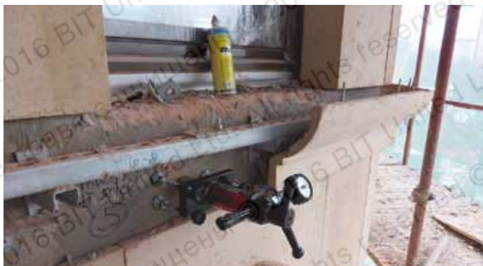
Приемо-сдаточные испытания анкеров для крепления подсистемы архитектурных изделий, выполненных из стеклофибробетона (пустотелый кирпич, диаметр шпильки M10, глубина заделки L=110 мм)
