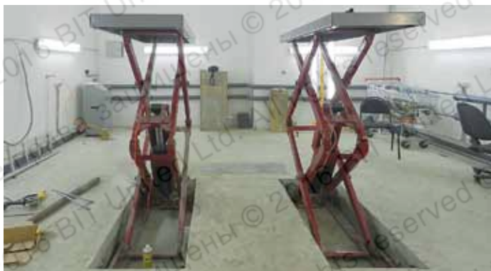
Крепление заглубляемого ножничного автоподъемника к бетонному фундаменту (увеличение глубины заделки анкерных элементов из-за несоответствия прочности бетона заявленной в проекте)
