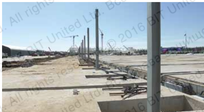
Монтаж колонн здания учебно-демонстрационного центра. Протяженность по фасаду 1560 метров (Военно-патриотический парк культуры и отдыха Вооруженных сил РФ «Патриот», Московская область, г. Кубинка, 2016 г.)
