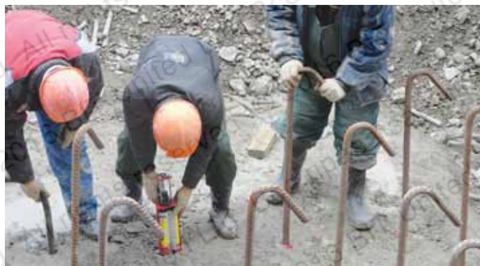
Устройство арматурных выпусков в существующей фундаментной плите (технологический регламент: очистка отверстий, инъектирование, установка арматурных стержней)
