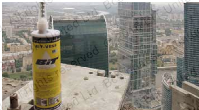
Монтаж подсистемы облицовки высотного здания «Меркурий Сити Тауэр» (высокие требования к эксплуатационной надежности, герметичности соединений, пожарной безопасности, коррозионной стойкости и долговечности)
