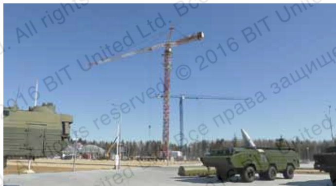
Монтаж башенных кранов и металлоконструкций к железобетонным фундаментам на объектах специального назначения (Российская Федерация, 2016 г.)
