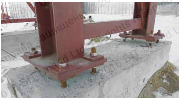
Крепление опорных колонн трубопроводов к монолитным фундаментам (минимальные расстояния от края железобетонного элемента)
