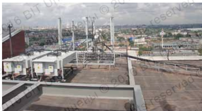
Крепление опорной рамы и растяжек антенно-мачтового сооружения сотовой связи на крыше здания (высокие требования к сохранению герметичности кровли и климатическим воздействиям)
