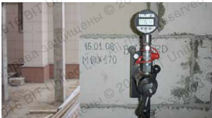
Испытания BIT-NORD в кладке из ячеисто-бетонных блоков (резьбовая шпилька М10, глубина заделки L=170 мм, максимальная нагрузка 5,78 кН)
