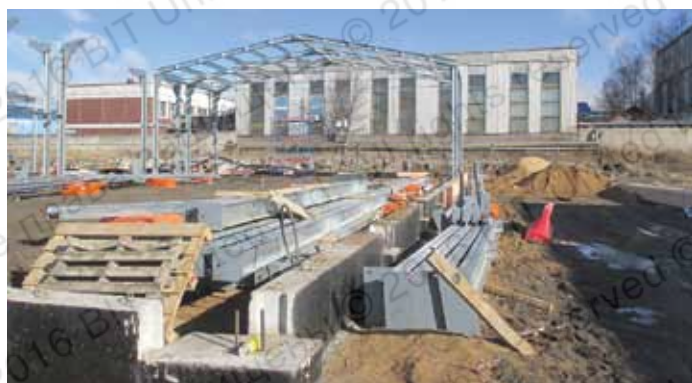
Крепление каркаса быстровозводимого здания к стандартным фундаментным бетонным блокам: шпилька М20, глубина заделки L=300 мм (Складской комплекс, Ленинградская область, Гатчинский район, 2011 г.)
