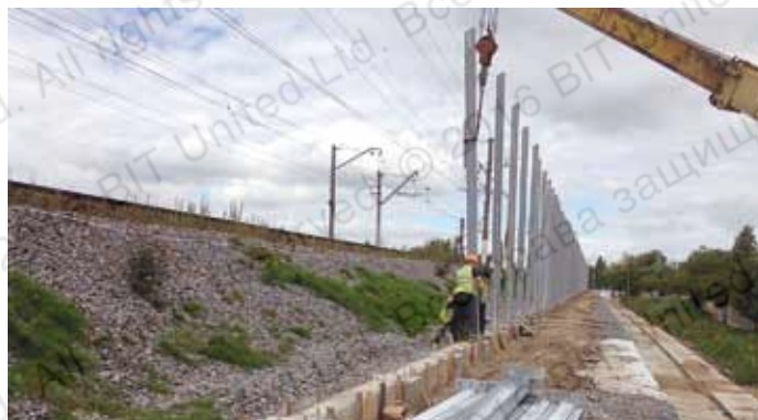
Монтаж металлических стоек шумозащитных экранов к железобетонному ростверку вдоль железнодорожных путей (г. Павловск, 2013 г.)
