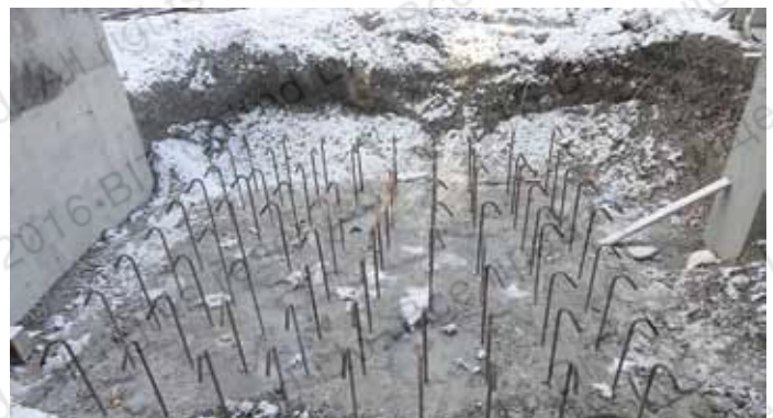
Устройство арматурных выпусков при увеличении толщины фундаментной плиты: арматура d=36 мм, глубина заделки L=1000 мм (Завод по производству цемента, г. Новороссийск, 2012 г.)
