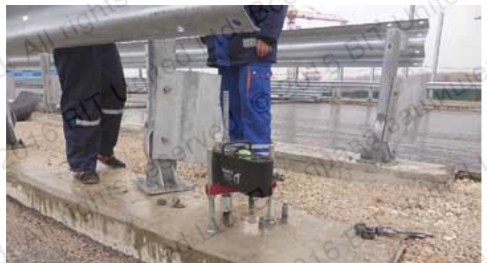
Испытание несущей способности анкерной группы крепления барьерного ограждения (расчетная несущая способность 35,7 кН)
