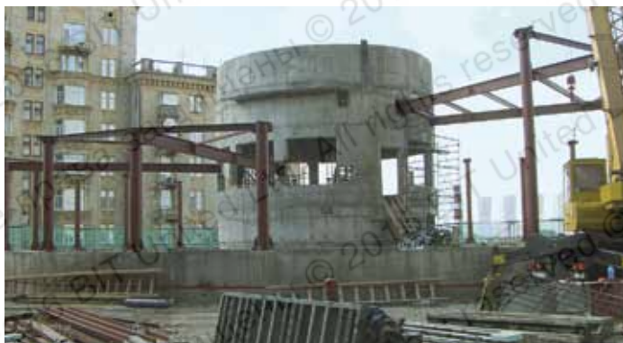
Исправление ошибок, допущенных при проектировании опорной зоны колонн въездного пандуса административно-гостиничного комплекса (МФК «Монарх-центр», Москва, 2007 г.)
