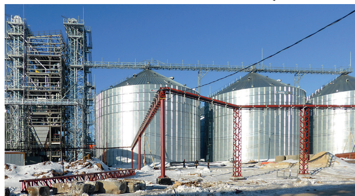
Строительство биотехнологического комплекса глубокой переработки пшеницы (АО «Биотех Росва», г. Калуга, 2014 г.)
