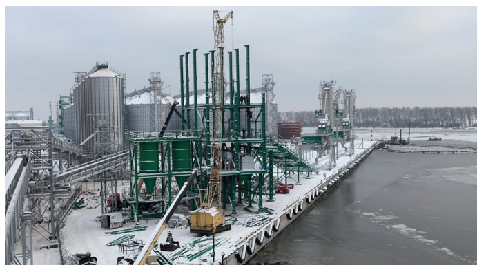
Монтаж металлоконструкций, силосов и элеваторов в зимний период (маслоэкстракционный завод «Содружество-Соя», Калининградская область, г. Светлый, 2012 г.)
